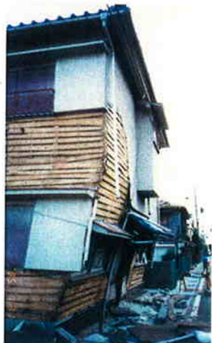
木造建物の地震被害
